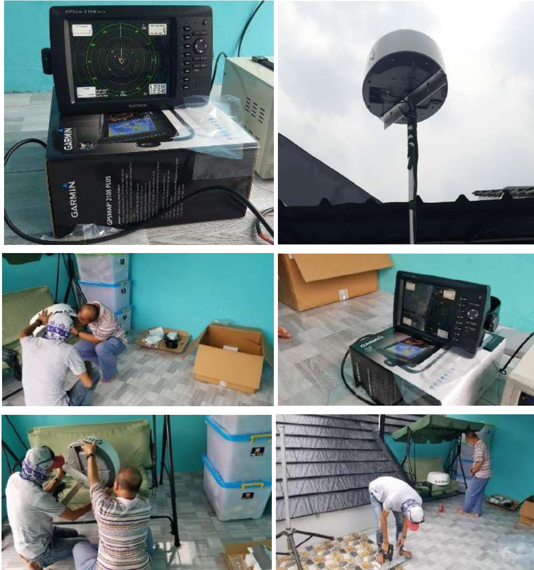
Gambar 6.44 Instalasi Radar pada FECABS
