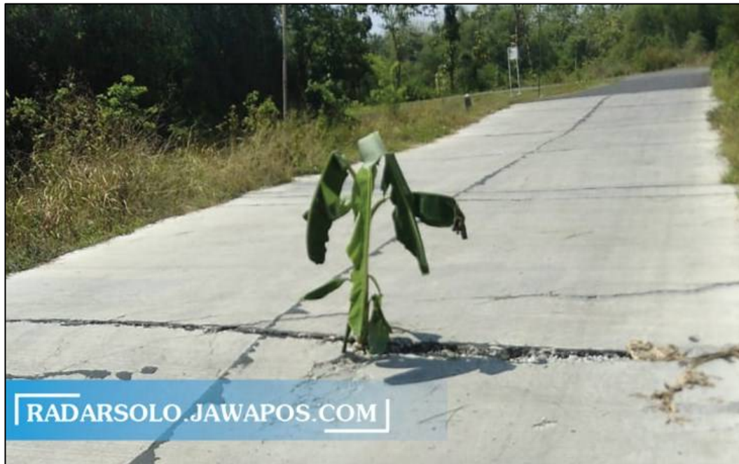
Gambar 4.11 Gerakan Tanah di Jalan Desa Krikilan 2 Sumber: Solopos (2021)
