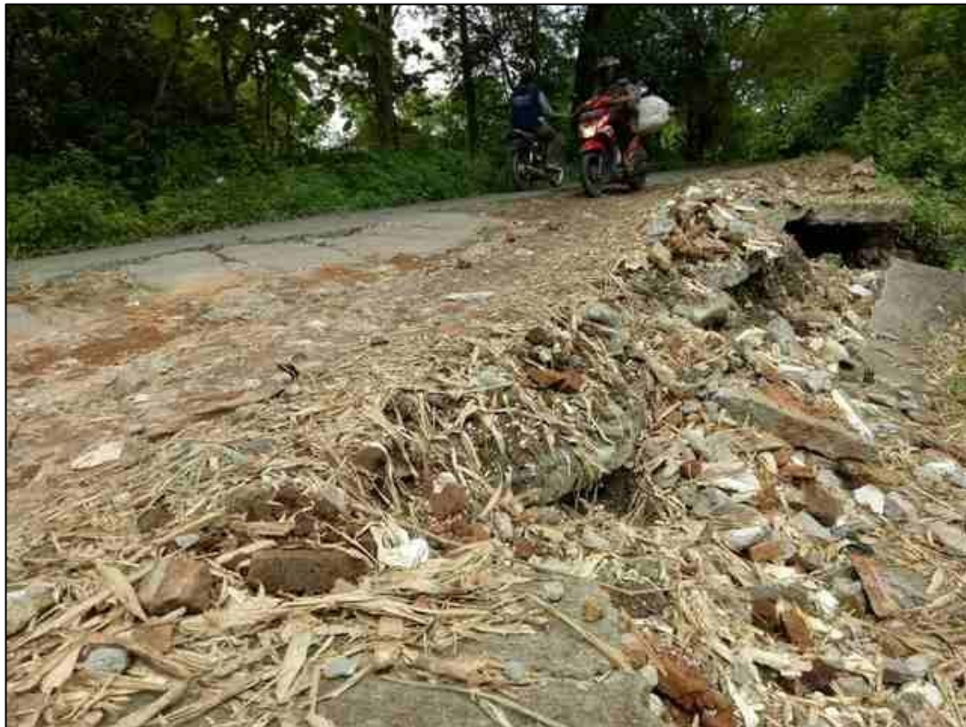
Gambar 4.9 Gerakan Tanah di Jalan Desa Krikilan 1 Sumber: Solopos (2017)
