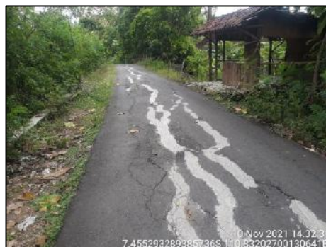
Gambar 4.38a Penutupan Rekahan di Jalan Sumber: diolah oleh peneliti
