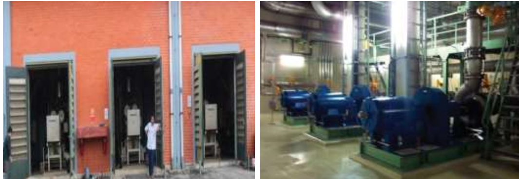
Gambar 4.21 Tiga Buah Pompa Pendingin Primer RSG-GAS (kanan) dan Tiga Buah Diesel Generator RSG-GAS (kiri)
