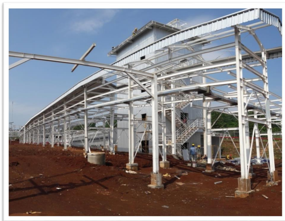
Foto Pipe Rack
