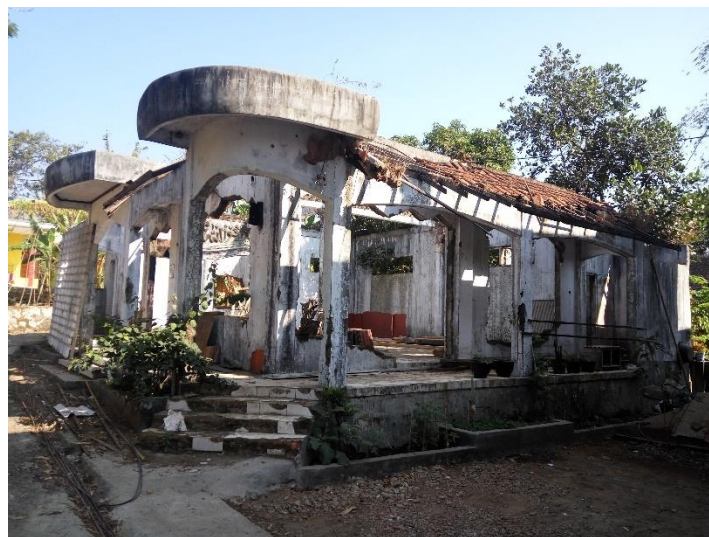
Gambar 4.3. Kondisi Masjid Nurul Islam setelah pembakaran 99
