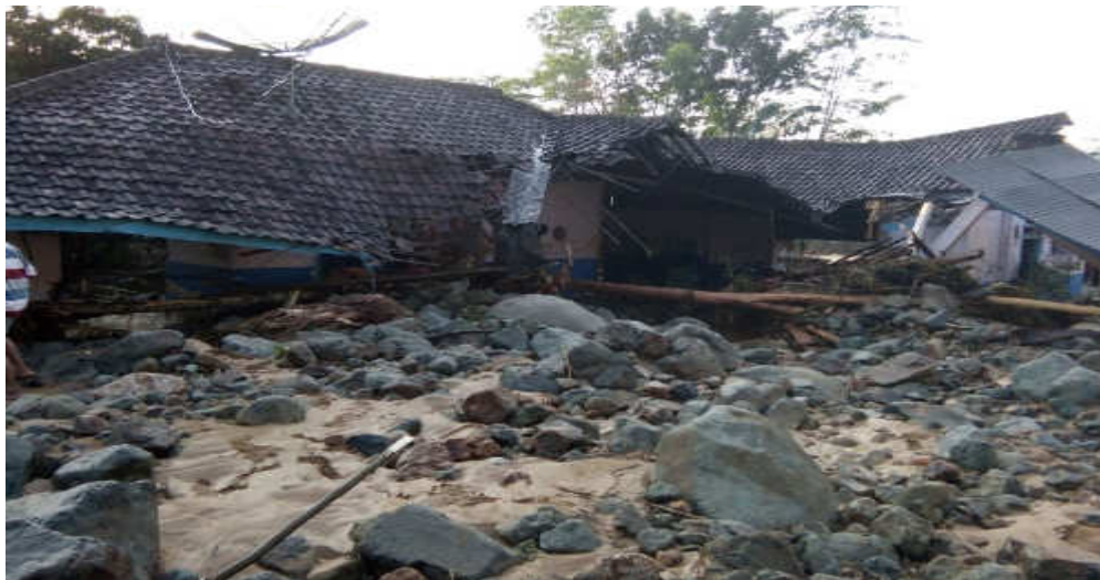
Gambar 4.2 Rumah Rusak akibat Banjir Bandang
