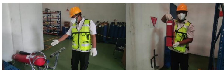
Gambar 4. 3 APAR yang Digunakan
