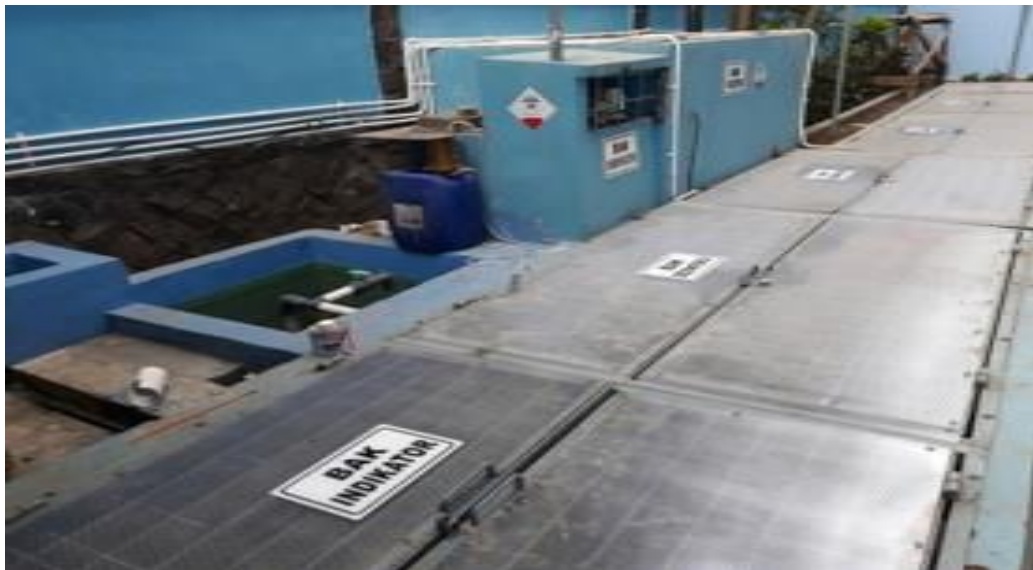
Gambar 4.3 Instalasi Pembuangan Air Limbah (IPAL)
