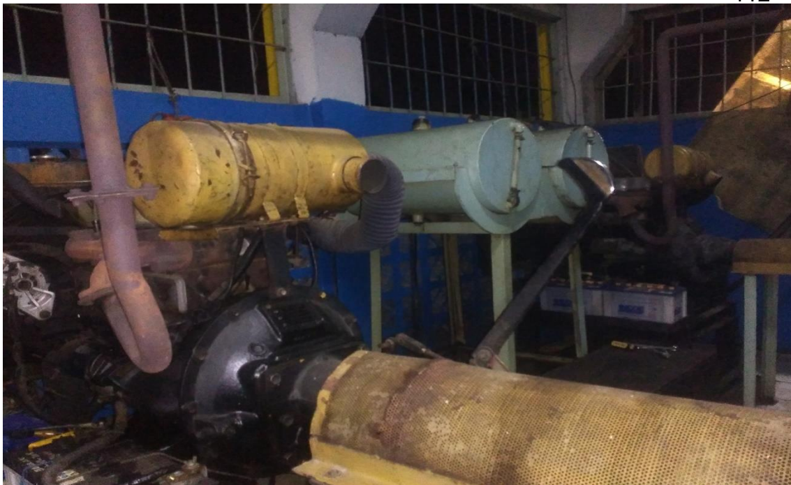
Mesin Pompa utama di Gedung Pompa IKPN Bintaro
