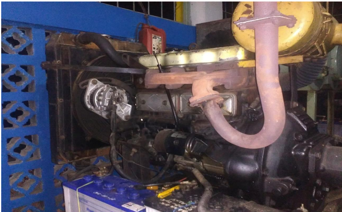
Kondisi Mesin Pompa Air di Gedung Pompa IKPN Bintaro
