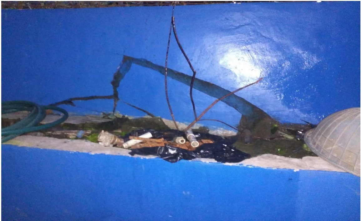
Kondisi tembok kali yang pecah
